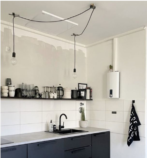
Deckenheizung in der Küche.
